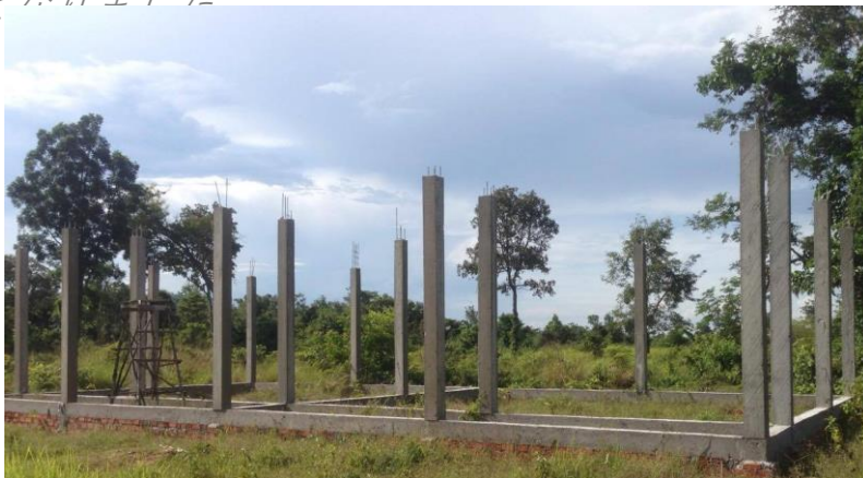
2017年2月に資金不足のため中断された学校建設プロジェクト
